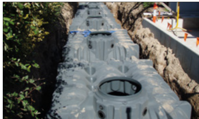
30.000 l (7.926 US gal), Planta industrial, Geelong (Australia)
