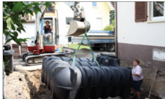
5.000 l (1.325 US gal), Vivienda particular, Teningen (Alemania)
