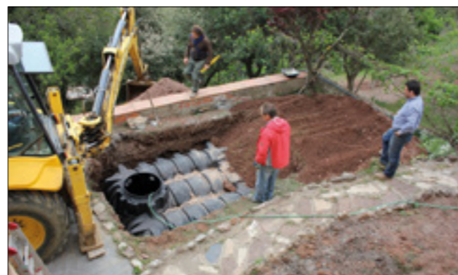
3.500 l (925 US gal), Edificio, Vacarisses (España)
